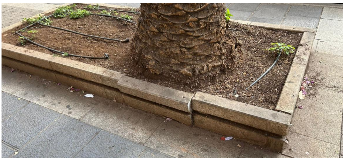
Figura 68. Alcorque mal dimensionado para albergar árboles. Fuente: elaboración propia.
